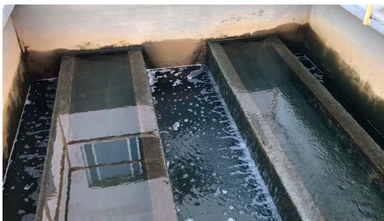
Figura 5 – Filtro da ETA mostrando o processo de filtração descendente (polimento)
