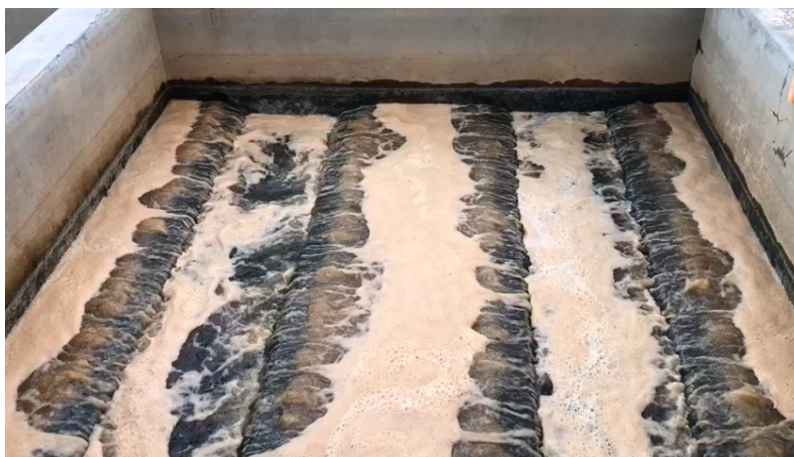
Figura 6 – Filtro da ETA mostrando o processo de lavagem ascendente
