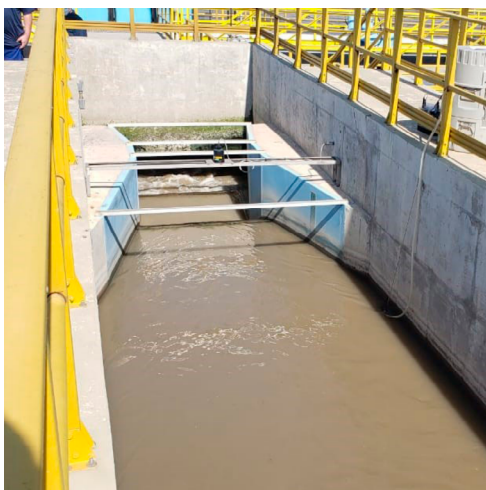
Figura 1 – Imagem de calha Parshall em ETA
