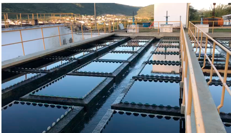
Figura 4 – Decantadores da ETA, Compesa Arcoverde (PE)
