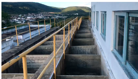
Figura 3 – Floculadores da ETA, Compesa Arcoverde (PE)
