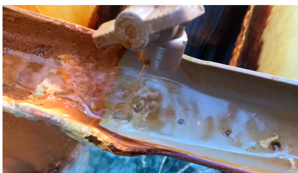
Figura 2 – Ponto de aplicação do sulfato de alumínio na ETA, Compesa Arcoverde (PE)
